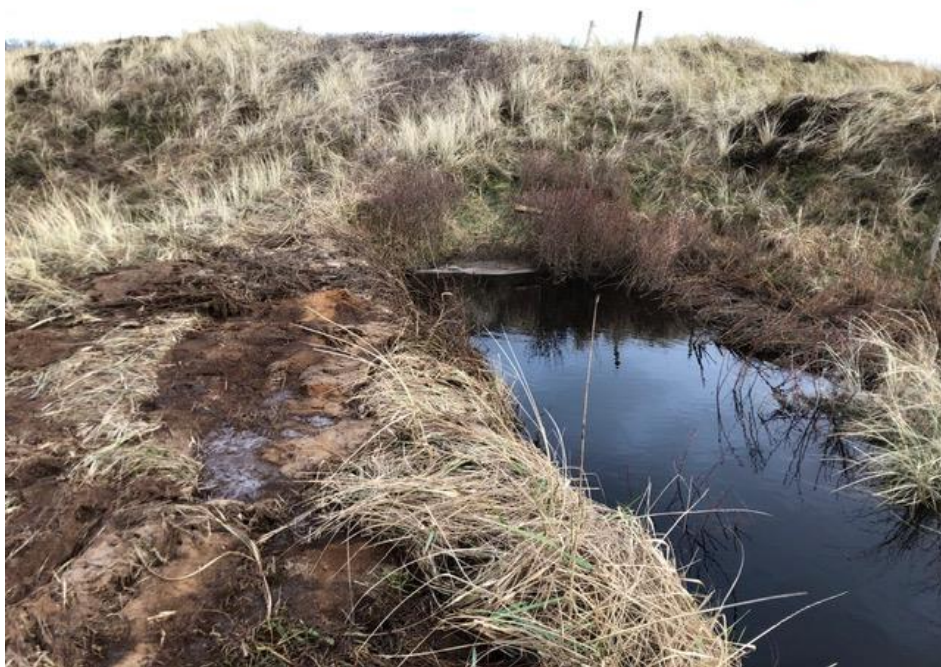
Foto 5 - Opstuvning af vand i grøften hvor den åbne grøft går i betonrør.
