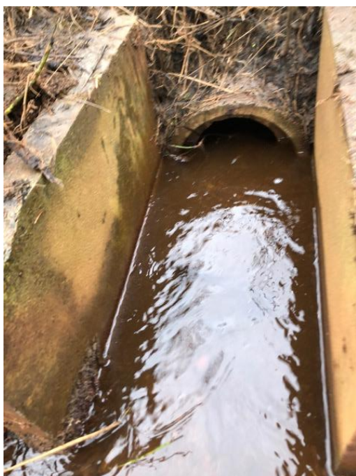
Foto 6 - Grøfteudløbet efter vandet er faldet igen.
